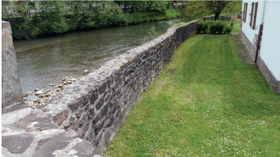
Figura 25. Muro permanente de protección frente a inundaciones
